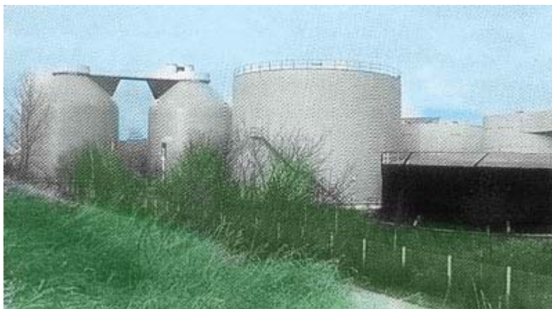
Рис. 17. Комунальна біогазова установка (анаеробний етап очисної споруди) [Барбара Эдер, Хайнц Шульц, 1996]
